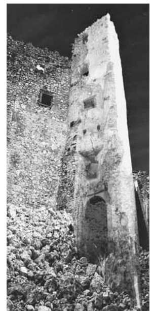
Obr.9: Projekcia deštruovanej bašty bránovej (zdroj: autor)
