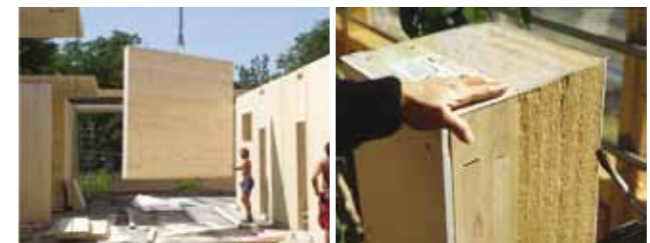
Obr. Stavební materiály – dřevěné panely, dřevěná izolace, příprava hliněné omítky – rákosové rohože a stěnové topení
