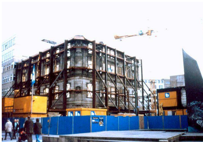
Obrázek 55 statické zajištění fasády při znovuvýstavbě všech ostatních konstrukcí, Frankfurt nad Mohanem, foto Peřinková M
