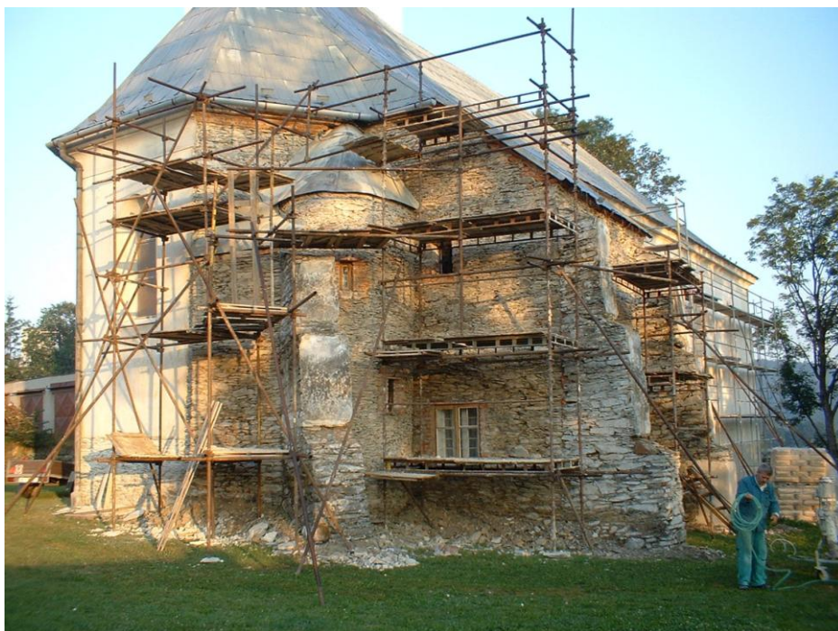
Obrázek 17 Břidličná, kostel Tří Králů. Opěráky sakristie přisazené jako dodatečné zpevnění jsou jednoznačně odlišitelné podle použitého materiálu, malty i směru ložných spar.
