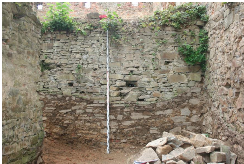
Obrázek 31 Velká Polom, tvrz, fotografický podklad pro kresebnou dokumentaci zdi s geodetickou latí. Foto Augustinová, 2009.
