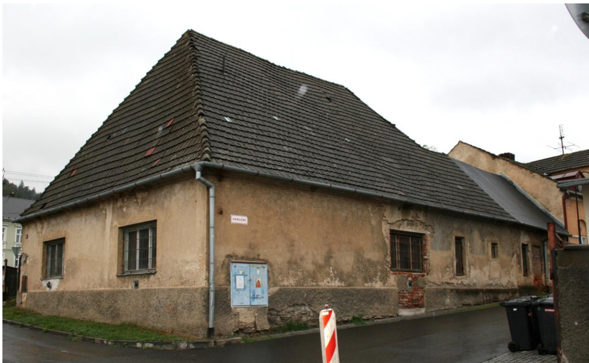
Obrázek 27 Odry, věznice čp. 83, solné výkvěty projevující se na fasádě nad betonovým soklem. Augustinová, L.: Stavebně historický průzkum věznice v Odrách. Ostrava 2006.
