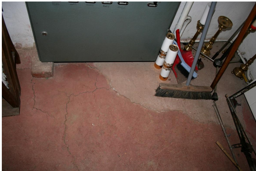
Obrázek 25 Šenov u Nového Jičína, kostel sv. xylolitová podlaha v sakristii vyspravovaná cementovou plombou. Kouřilová, D. – Augustinková, L.: Kostel sv. Martina v Šenově. Nálezová zpráva. Ostrava 2006.
