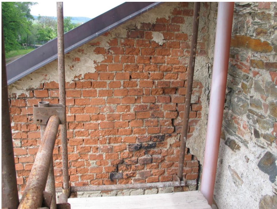
Obrázek 16 Fulnek, klášter. Spára vydělující cihlové zdivo mladší oratoře nad sakristií a smíšené zdivo kostela. Rosová, R. – Augustinová, L.: Stavebně historický průzkum bývalého kapucínského kláštera ve Fulneku. Ostrava 2002.
