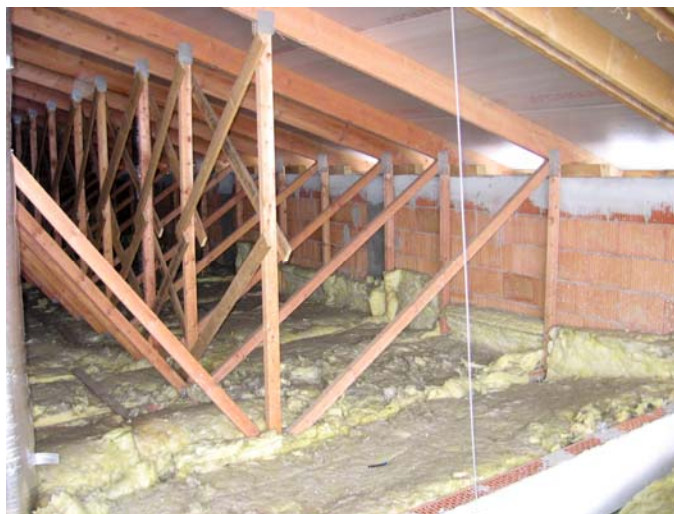
Obrázek 1 : Konstrukce střešních vazníků havarovaného supermarketu Lidl v Ostravě.
