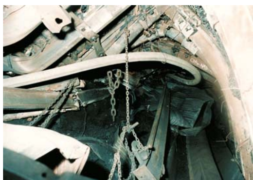
Obr. 1: Deformace obloukové výztuže po důlním otřesu
