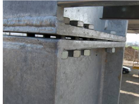
Obr. 2: Roztvorenie spojov na stĺpe
