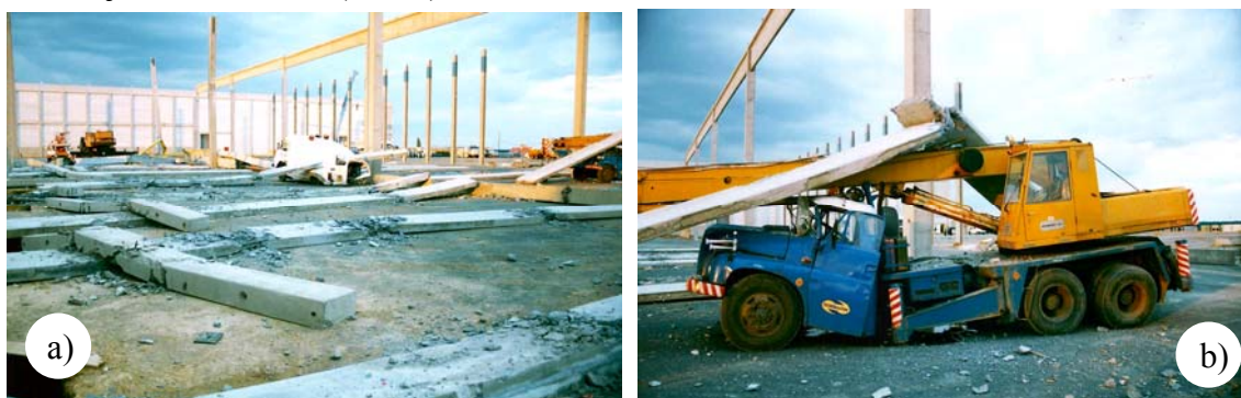
Obr. 1: Pohled na přístavbu po havárii (a), pohled na zničený autojeřáb (b)
