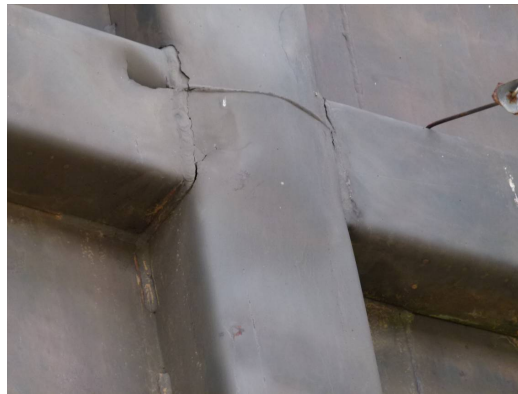
Obr. 2 Detail poruchy výstuh
