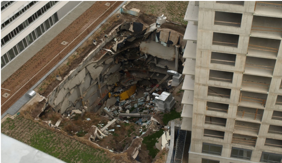
Obr. 1: Pohľad na zrútenú časť konštrukcie
