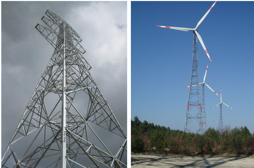
Obr. 1: Ocelové příhradové stožáry z rovnoramenných úhelníků
