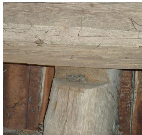
Obr. 3: Poškozený styk vaznice a krokve
