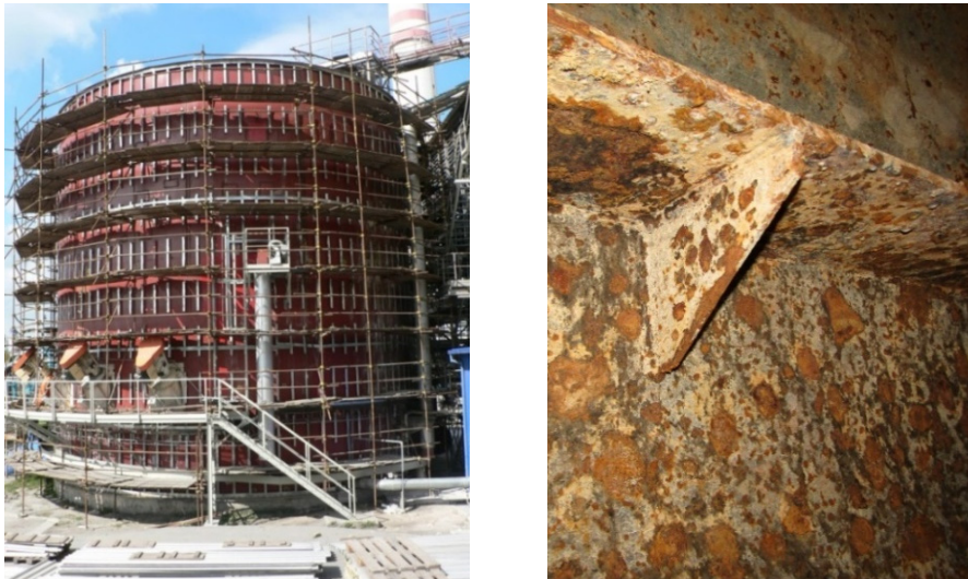
Obr. 1: Nádrž na vápencovou suspenzi – ČEZ, a.s. (vlevo), zkorodovaný vnitřní povrch nádrže v místě prstencové výztuhy (vpravo)
