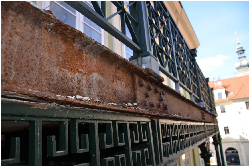
Obr. 1: Balkon Stavovského divadla a nosník se zkorodovaným povrchem
