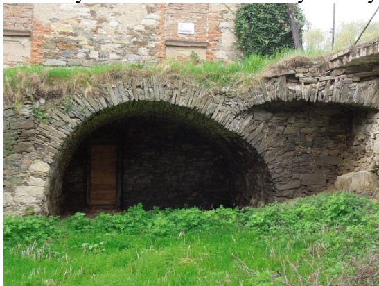
Obrázek 2 - Poškození klenby s vlivem na geometrii konstrukce
