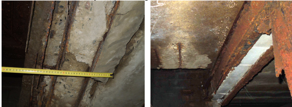
Obrázek 1 - Typické poškození betonové (vlevo) a ocelové (vpravo) konstrukce
