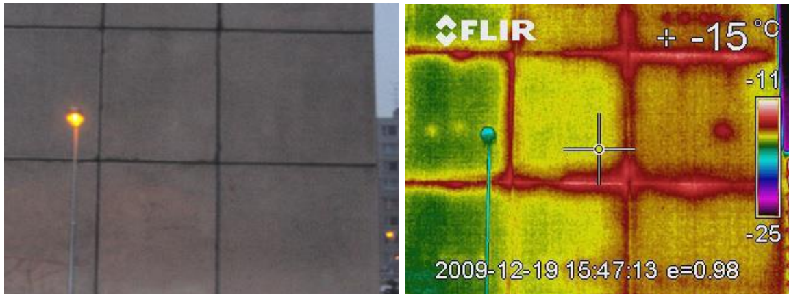
Obr.8 Detekce nevyhovujících tepelně-izolačních vlastností obvodových stěn.
