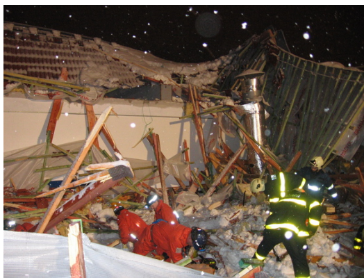
Obr.1 Prostor prodejny po destrukci střechy
