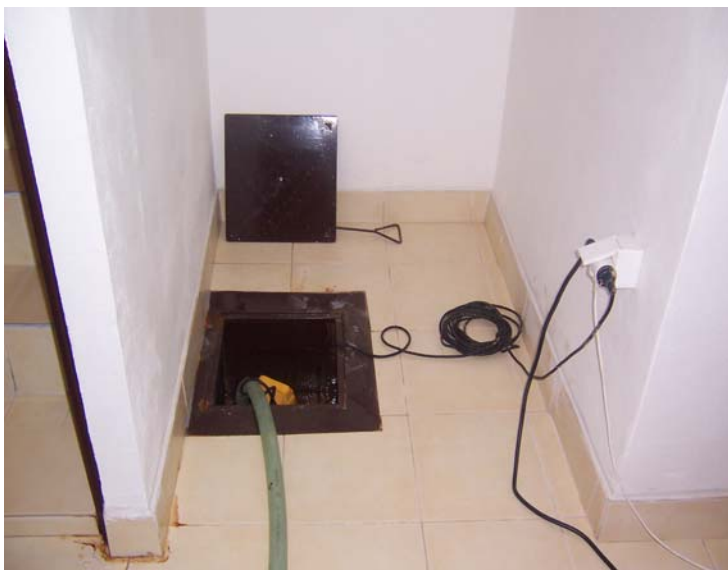
Obr.6 Sběrná čerpací jímka
