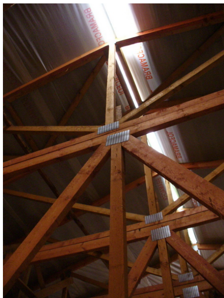
Obr.6 Vzájemné posunutí stojek horní a dolní části
