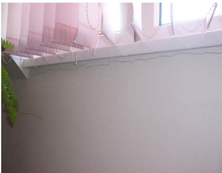
Obr.9 Poruchy objektu u parapetu
