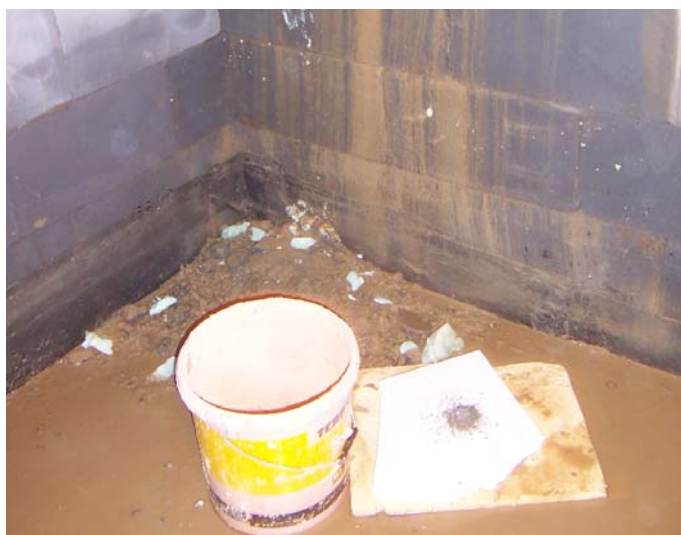
Obr.4 Plynosilikátové vlhké zdivo v suterénu při výstavbě
