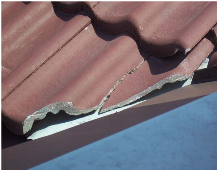
Obr.10 Poruchy objektu na střešní krytině
