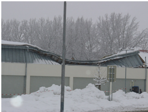
Obr.2 Pohled na zřícenou část střechy prodejny
