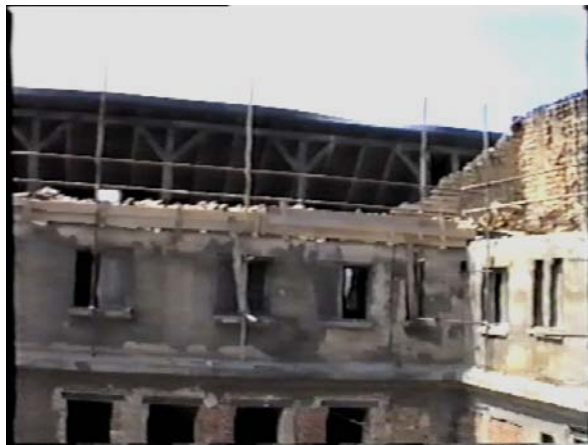
Obr.2: Pravá část zřícené stěny
