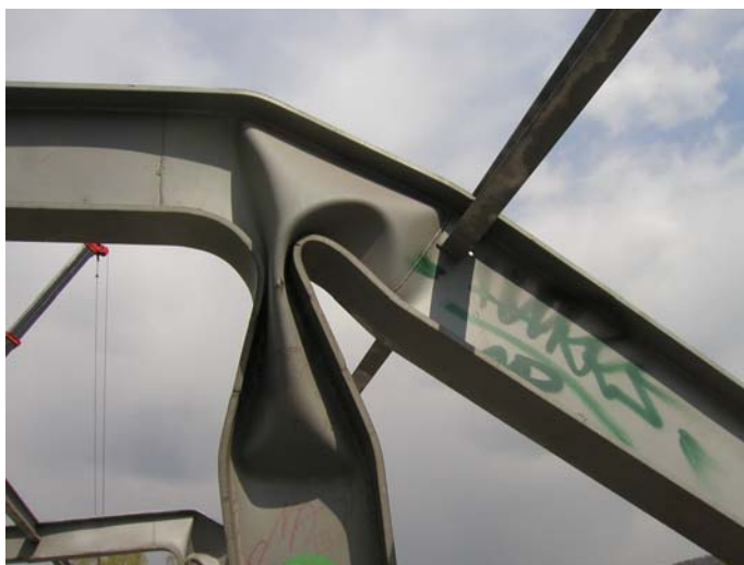
Obr.3 Detail zdeformovaného styčnicku a demontované krytiny.
