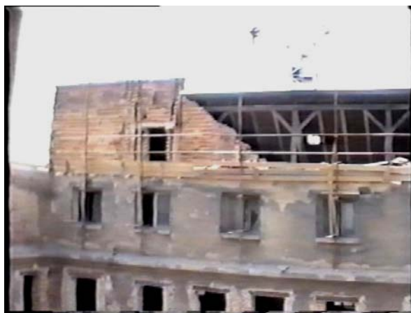
Obr.1: Levá část zřícené stěny
