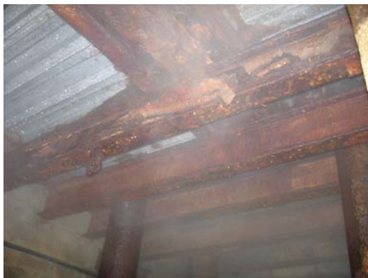
Obr.8: Vysoký stupeň koroze ocelových konstrukcí
