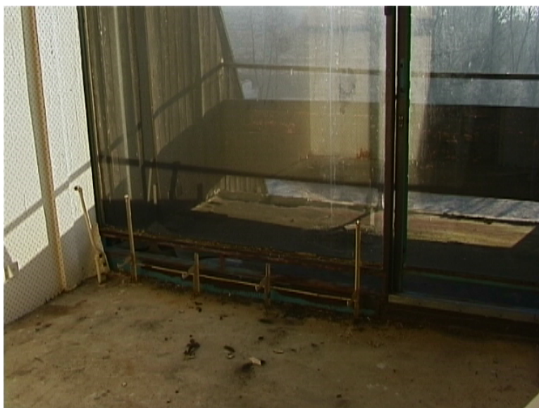
Obr.8: Čelní prosklená stěna pokoje – chybějící radiátory ÚT
