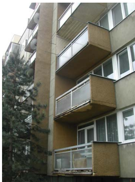
Obr. 3 Trhliny balkónu a pohled na průběžnou stěnu sousedního balkónu
