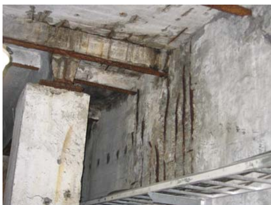
Obr.10: Vysoký stupeň koroze výztuže stěny
