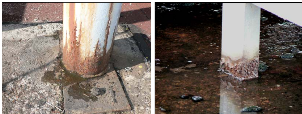
Obr. 6: Ilustrační příklady koroze spodních částí nosných sloupů.
