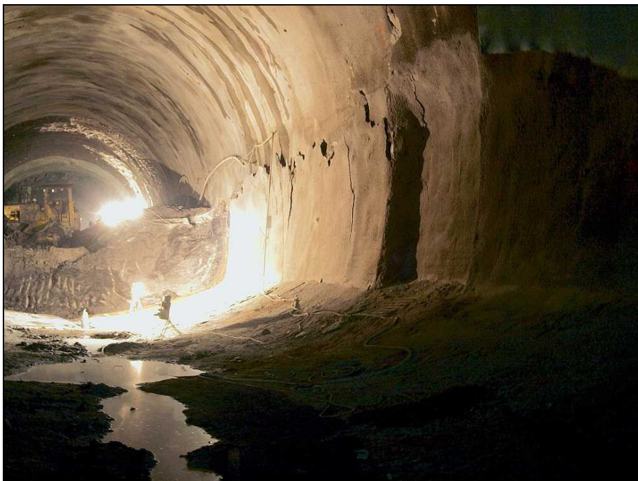
Foto 1. Foto z místa vzniku havárie -smykové porušení v pravém boku ostění
