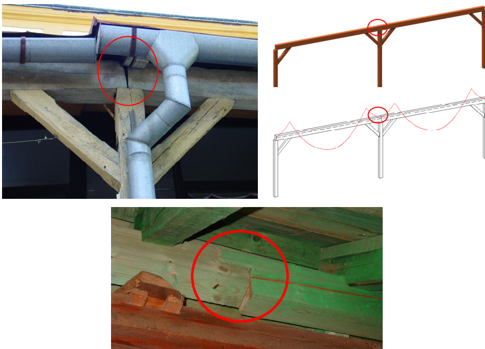
Obr.9: Nevhodná řešení montážních styků vazných trámů (změna statického schématu nevhodným detailem, velké deformace, porušení nosného prvku)
