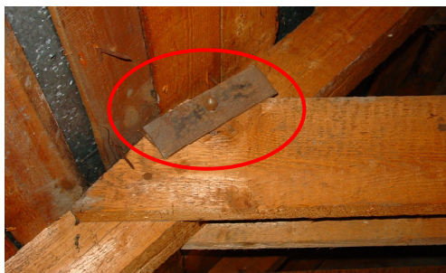
Obr.8: Nevhodné řešení připojení kleštin ke krokvi (zcela zbytečné excentrické připojení, nedodržení minimálních roztečí)
