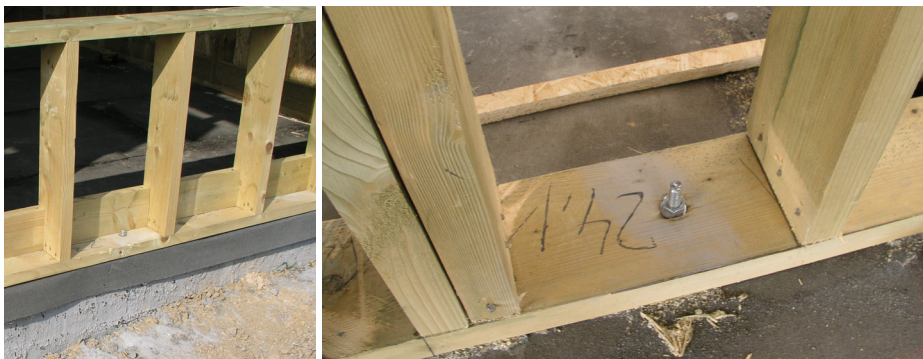
Obr.5: Nedostatečné a nesprávně provedené kotvení prahového nosníku: (kotevní šrouby bez podložek (lokální poškození prahového nosníku), neprovedení výtuzných stěn)
