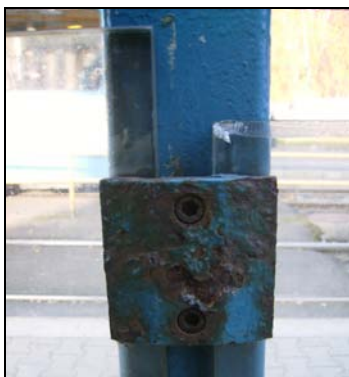
Obr. 4: Úchyt poškozený korozi
