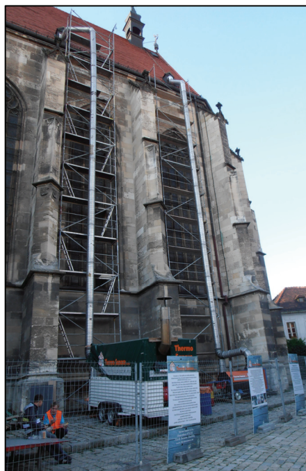
Obr. 2: Pohled na horkovzdušné ohříváče a rozvodná potrubí
