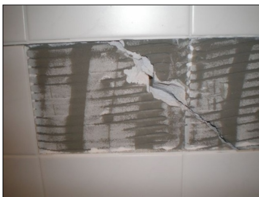
Obr. 3: Častá vada – trhliny v konstrukcích příček
