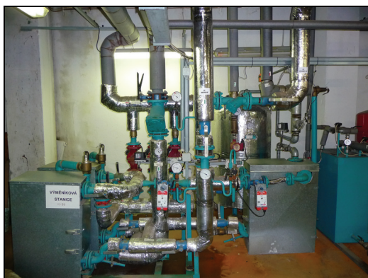
Obr. 2: Pohled na výměňkovou stanici vytápění [9]
