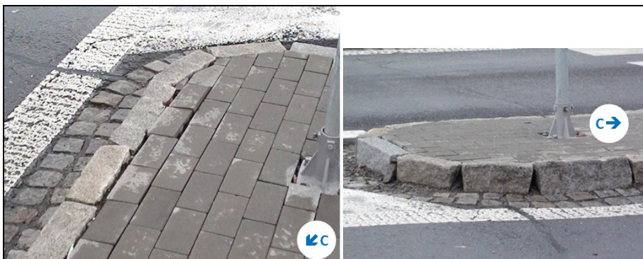
Obr. 11: Porušený obrubník ochranného ostrůvku na rameni C
