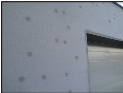
Obr. 2: Skvrny na zateplovacím systému II
