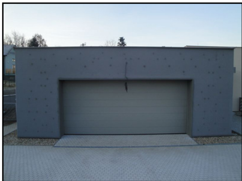
Obr. 1: Skvrny na zateplovacím systému I
