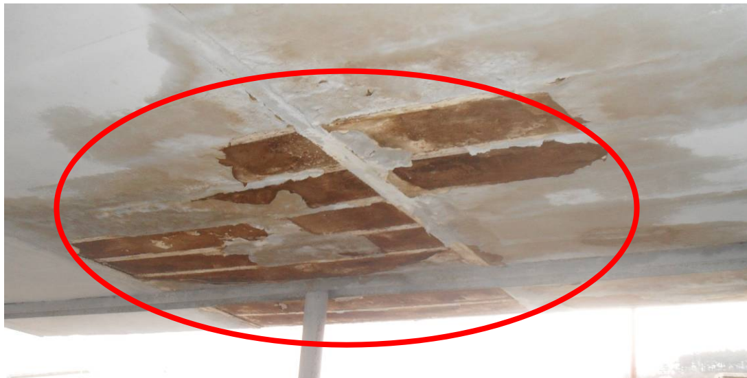
Obr. 12: Strop poškozeného přístřešku s opadávající omítkou a betonem
