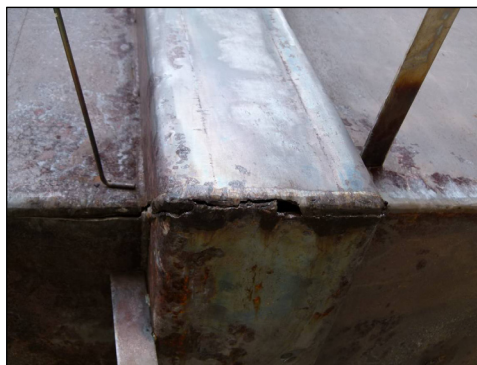
Obr. 3: Detail poruchy rohu výstuh
