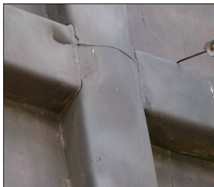
Obr. 4: Detail poruchy výstuh
